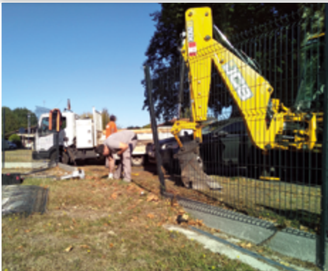
Château d'eau - Remise en état de la clôture dégradée
