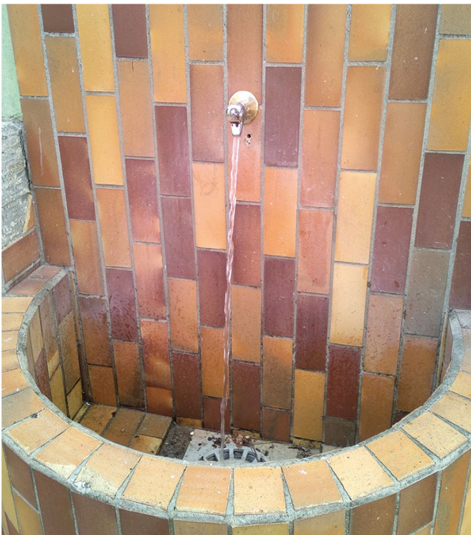
Réparation de la fontaine et des sanitaires publics très endommagés
